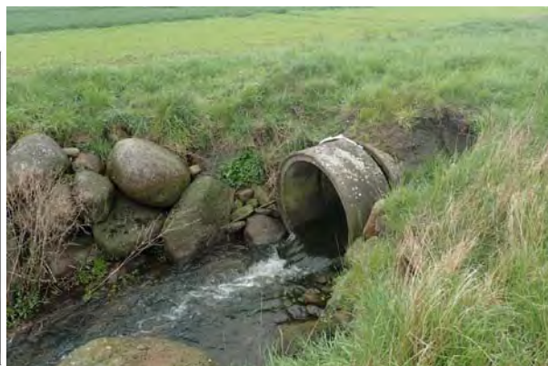
Sträcka 62, partiellt vandringshinder vid kulvert
