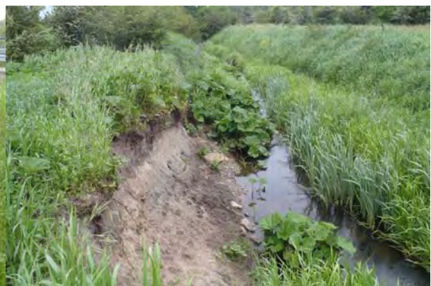
Sträcka 38, erosion, låg beskuggning!
