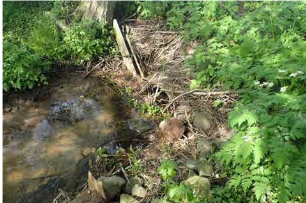
Ingång till kulvert, igentäppt med skräp och grenar
