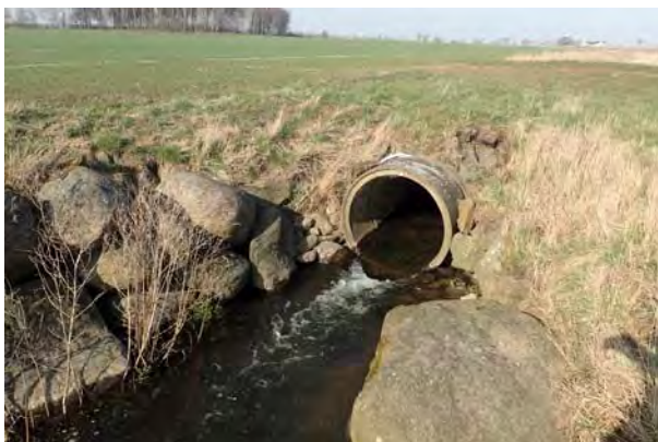
Foto 5.6 Partiellt vandringshinder vid kulvert (sträcka 62).
